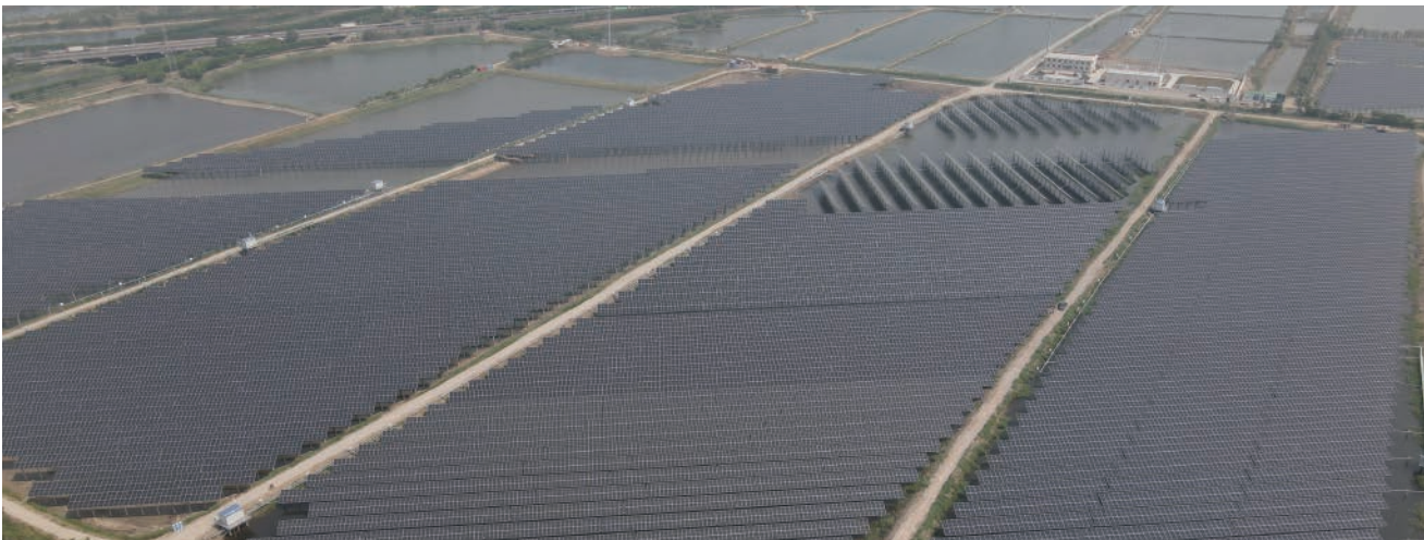
Tianjin, Chine Date de l'installation : 2021
