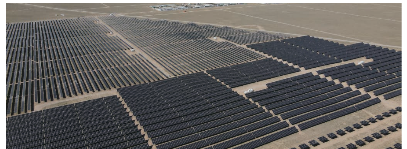
Qinghai, Chine Date de l'installation : 2024
